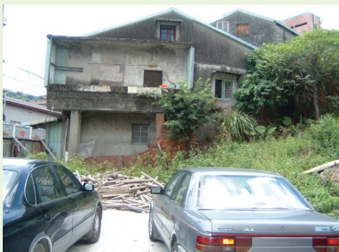
● 基隆三坑車站旁傾塌之舊建築物位於坑道上方。
