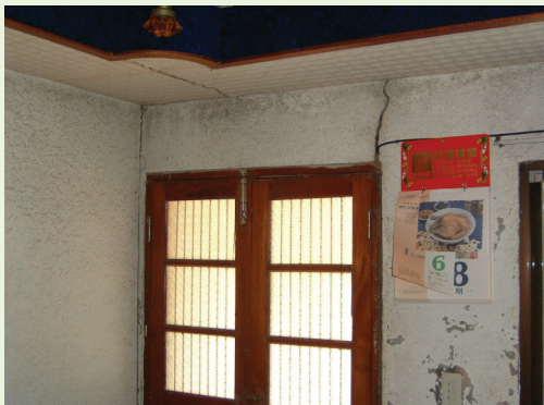
●八堵煤礦坑口附近羅萬住宅之房屋龜裂情形。
