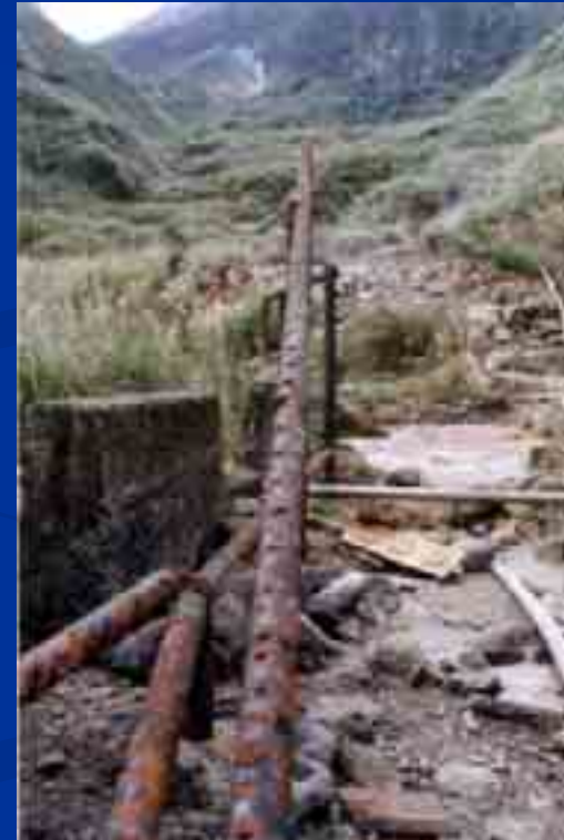
金屬管線腐蝕 產生許多小洞
