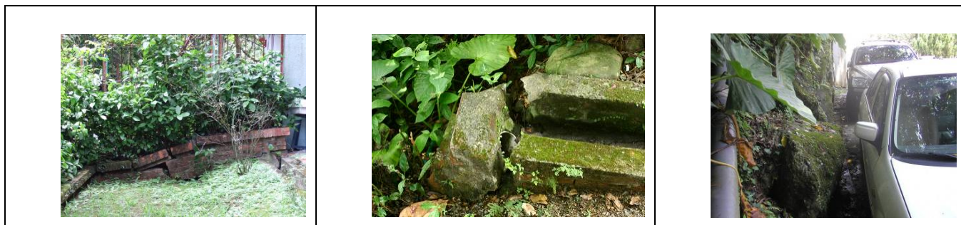
照片二十一 花園新城現地調查問題-地面下陷 、排水溝開裂，以及砌石擋土牆外凸現象
