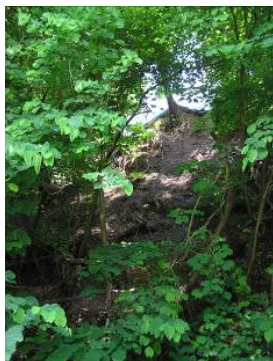
照片十 花園新城現地調查問題-路口處上方有些許落石崩塌
