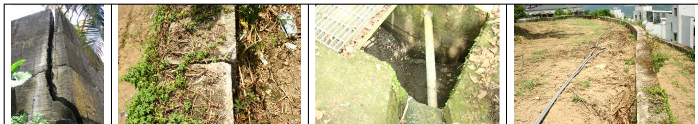
照片十一 花園新城現地調查問題-階梯式重力擋土牆及排水溝問題
