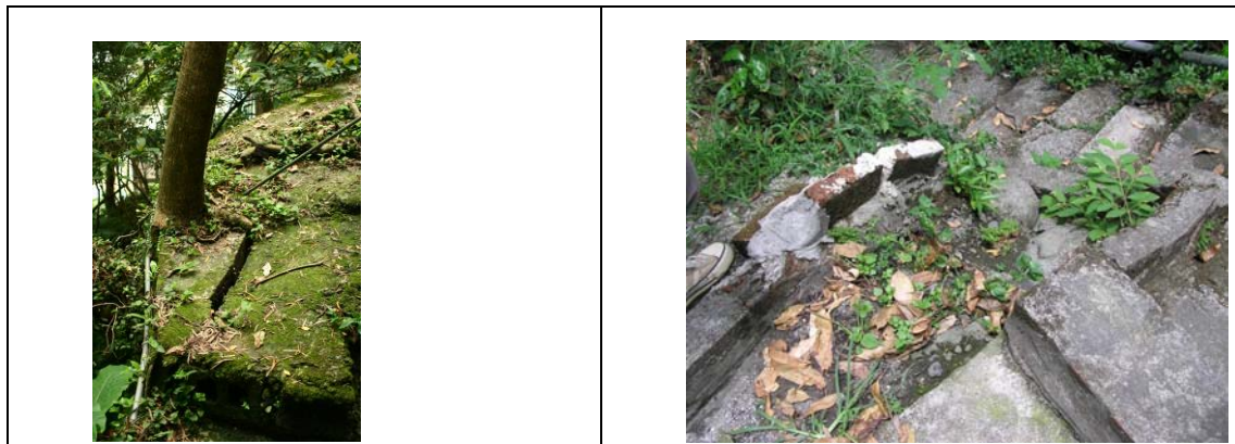
照片十五 花園新城現地調查問題-擋土牆與後方坡面明顯開裂
