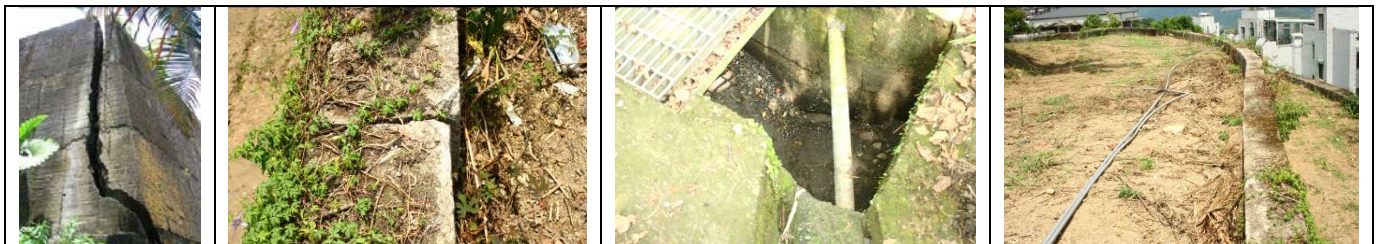
照片二十 花園新城現地調查問題-階梯式重力擋土牆及排水溝問題
