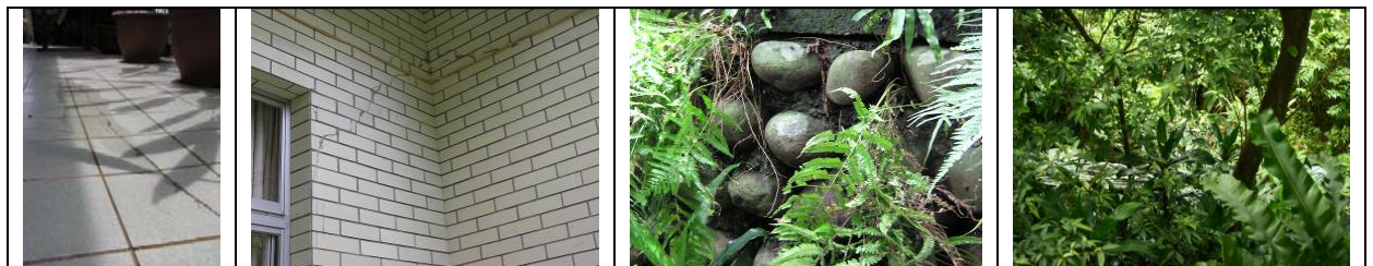
照片十三 花園新城現地調查問題-擋土牆及構造物裂縫，與邊坡沖刷
