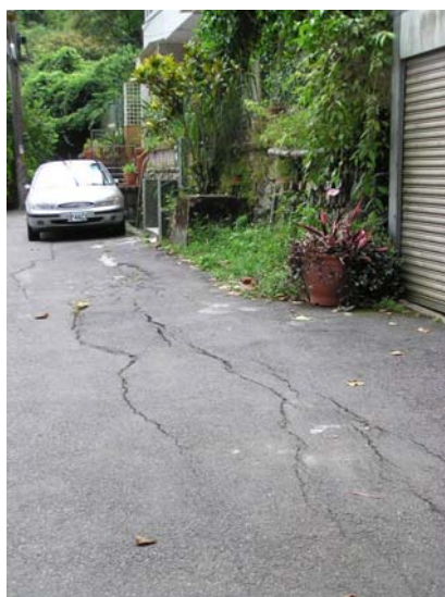
照片二十三 花園新城現地調查問題-邊坡陡峭，路面出現裂縫
