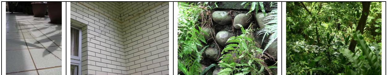
照片二十二 花園新城現地調查問題-擋土牆及構造物裂縫，與邊坡沖刷
