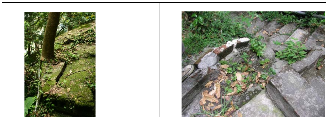
照片二十四 花園新城現地調查問題-擋土牆與後方坡面明顯開裂
