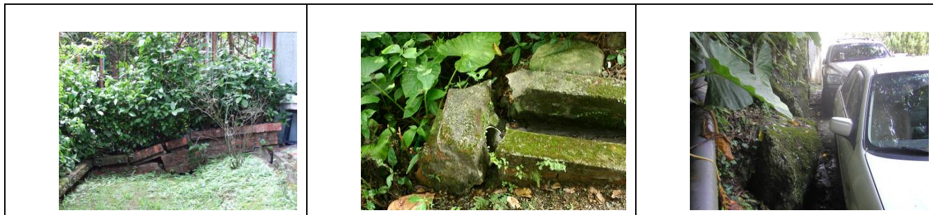
照片十二 花園新城現地調查問題-地面下陷、排水溝開裂，以及砌石擋土牆外凸現象
