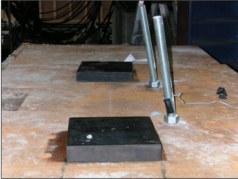
照片 3.1 橡膠支承墊直接放置在帽梁上
