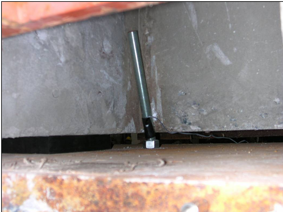
照片 3.10 上部結構之橫隔梁撞擊止震鋼棒
