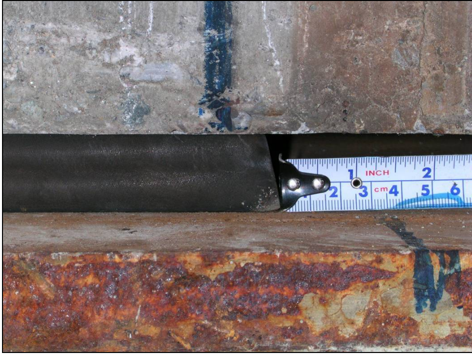
照片 3.7 支承墊在上部結構與帽梁處的滑動現象
