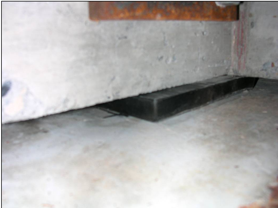
照片 4.3 支承墊因滑動產生永久位移
