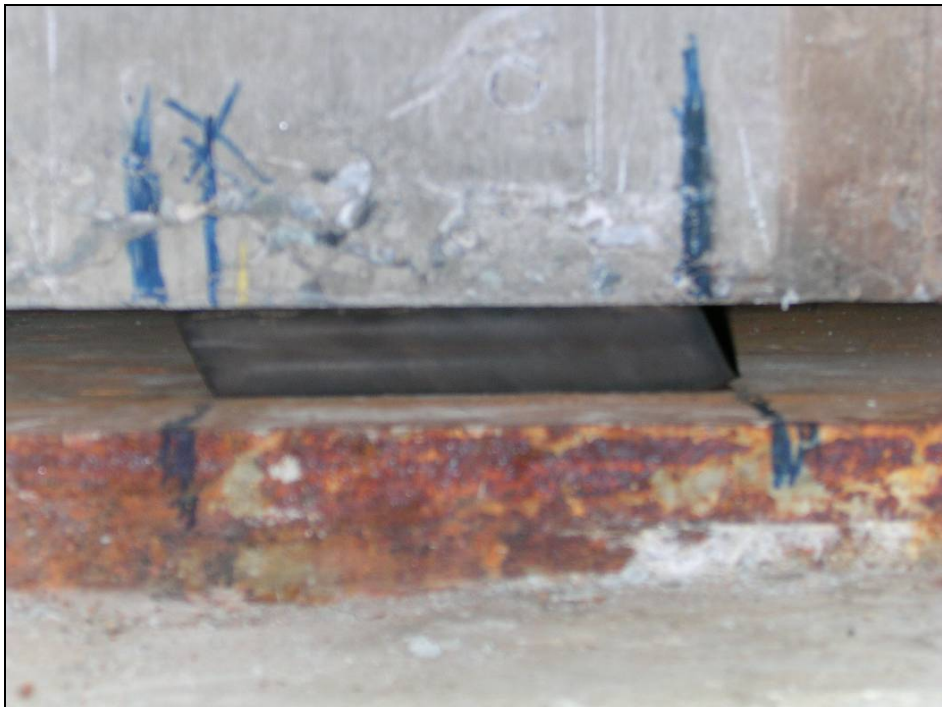
照片 3.6 試驗過程中支承發生翹曲的現象
