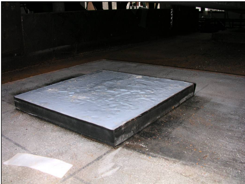
照片 4.5 支承墊在無收縮水泥砂漿表面殘留的磨擦痕跡
