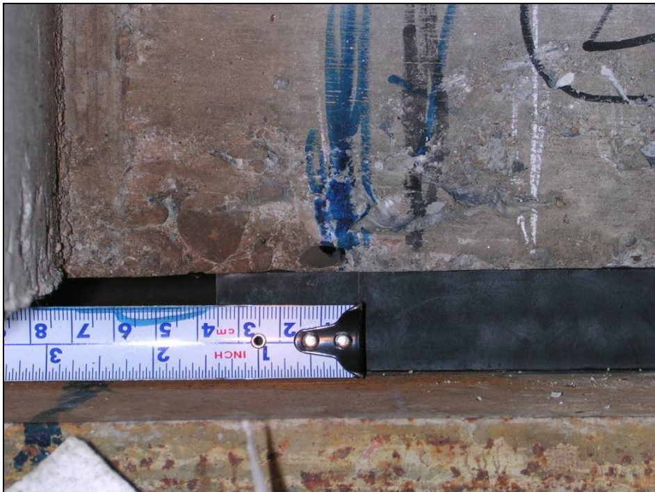
照片 3.8 上部結構與帽梁的相對位移
