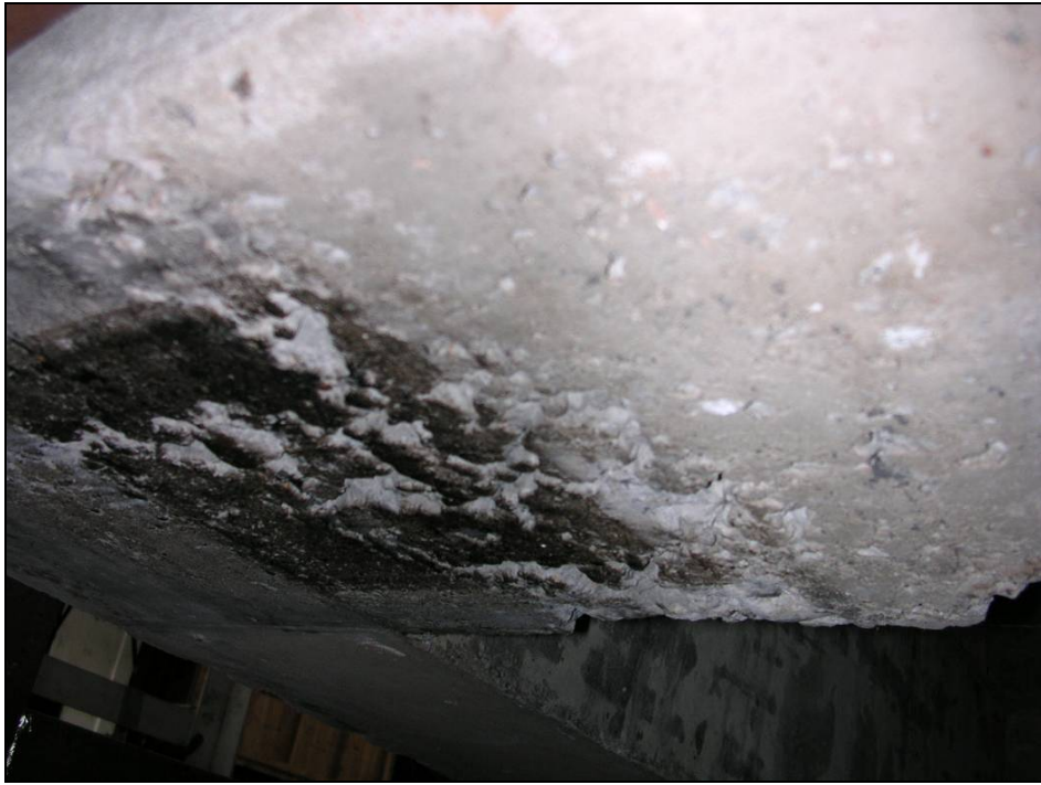
照片 4.4 上部結構因支承墊磨擦而破損
