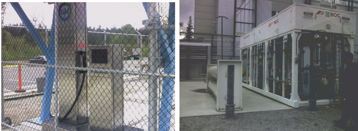
圖 5 加氫設備及儲存裝置。
